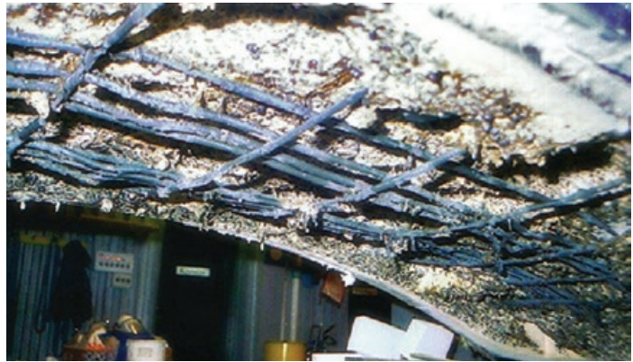
Yüksek sıcaklıkta test edilen betonarme elemanda meydana gelen dökülme
